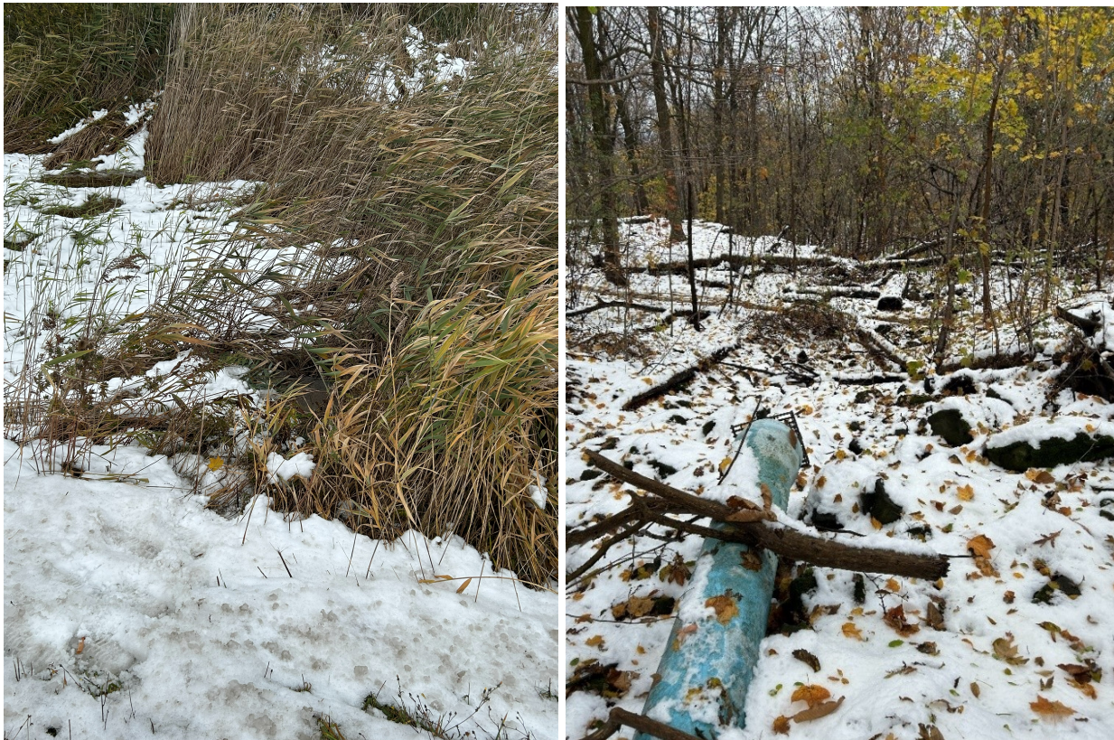
Figure 30: OPG Siphon Outlet
